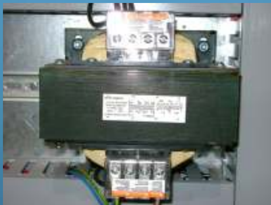
Трансформатор цепей управления
